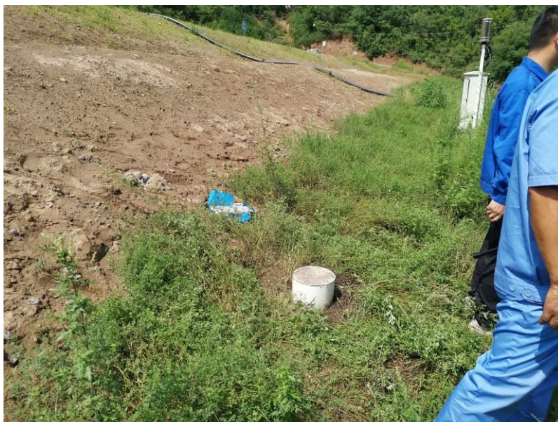
照片 22 在线浸润线观测管
